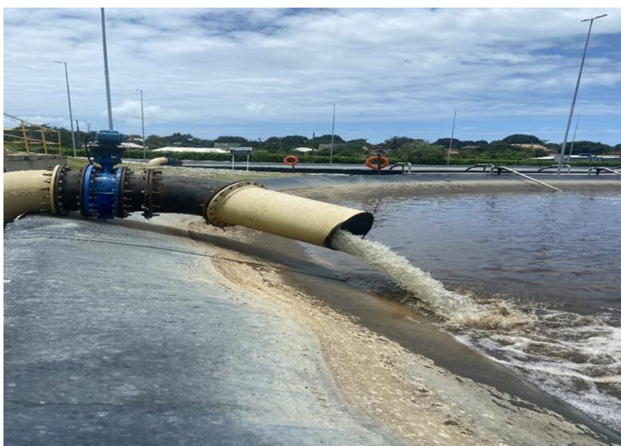
Figura nº 4: Estação de Tratamento de Esgoto Pontes Leites, 2024.
