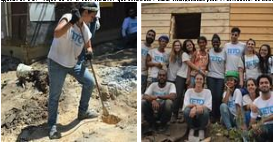
Figuras 16 e 17 - Ação da ONG Teto em 2019 que construiu 9 casas emergenciais para os moradores de Itaoca.
