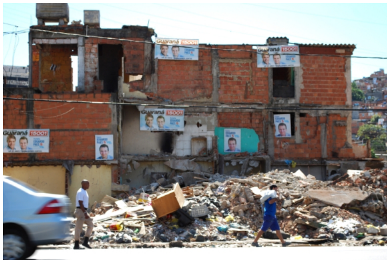
Figura 12 - Casas semidemolidas e escombros na Comunidade Metrô-Mangueira. Fonte: < https://comitepopulario.wordpress.com/2012/08/ >.
